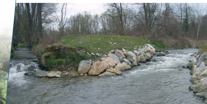
Deysse. La destruction du radier en béton a laissé place à une rampe en enrochements libres, désormais franchissable par les poissons.
